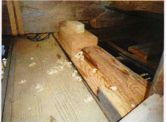
小屋内盤木腐れ部剥木 2017.10.30
